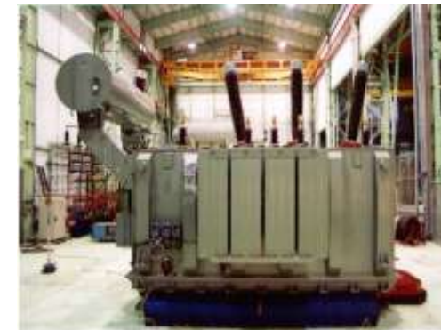
Μετασχηματιστής 150/21 kV, 50 MVA
