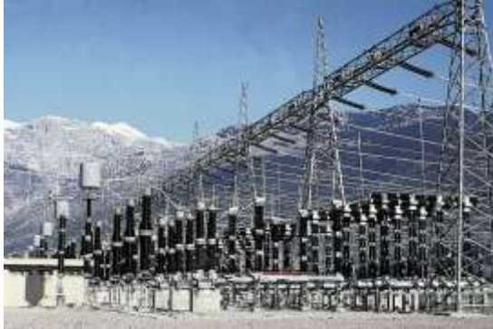
Κέντρο Υπερυψηλής Τάσης 400/150 kV
