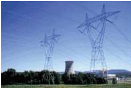
Γραμμή μεταφοράς 400 kV
