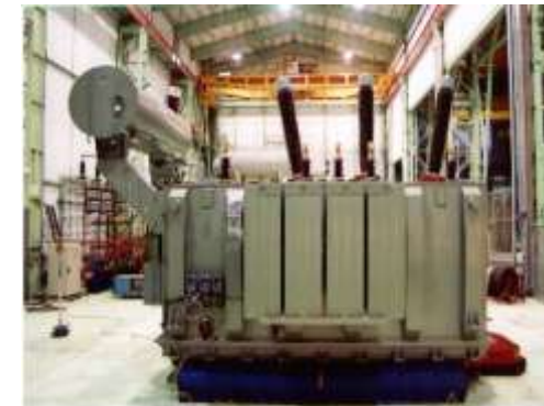
Μετασχηματιστής 150/21 kV, 50 MVA
